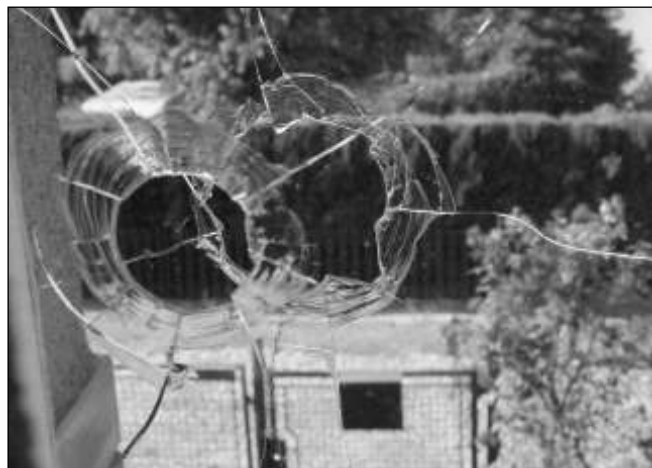
ČISTÝ PRŮSTŘEL. Prostřelené okno u řevnického domu manželů Zavadilových. Foto Petr ZAVADIL
