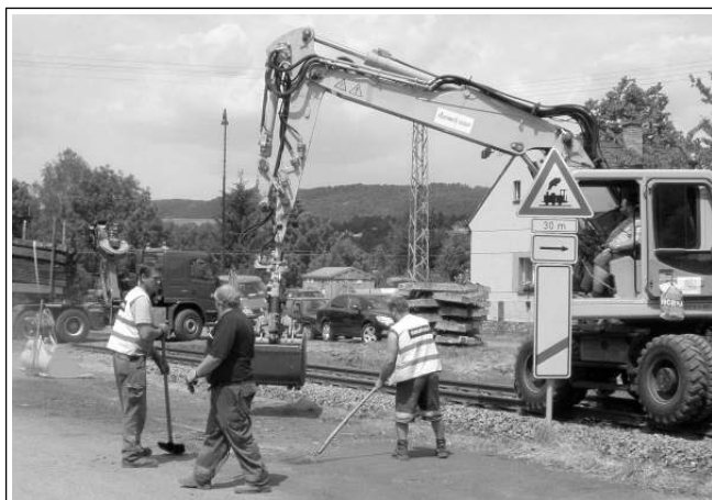
DESET DNŮ BEZ LOKÁLKY. Deset dní byl přerušen provoz na lokální železniční trati Zadní Třebská - Lochovice. Místo vlaků jezdily v této úseku autobusy. Důvodem byla oprava svršku, kolejí a tří přejezdů v Zadní Třebani. Práce stavební firma odvedla v termínu, takže od 31. května už zase lokálka jezdí podle jízdního řádu. V neděli 3. června také poprvé vyjel historický motorák, který bude mezi Karlštejnem, Zadní Třebani, Lochovicemi a Příbramí jezdit každou neděli až do 30. 9. (pef) Foto NN M. FRÝDL
