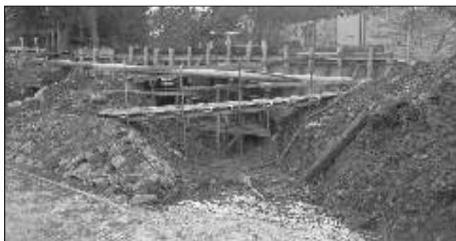
TADY BUDE MOST. Už šest měsíců trvá rekonstrukce malého mostu v Zadní Třebani. Neskončí dřív než v dubnu. Foto NN M. FRÝDL
